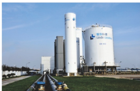
液化气体储罐
