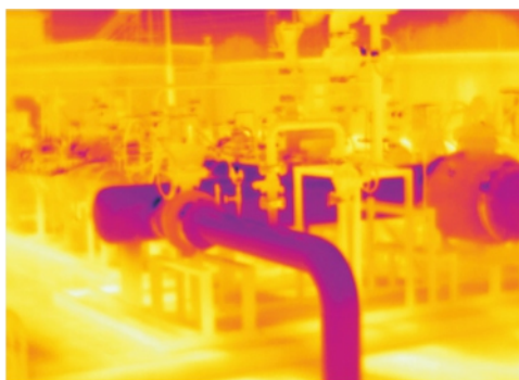
监测管道是否存在泄漏
